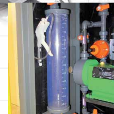
Dosage acide chlorhydrique 500 L/h
